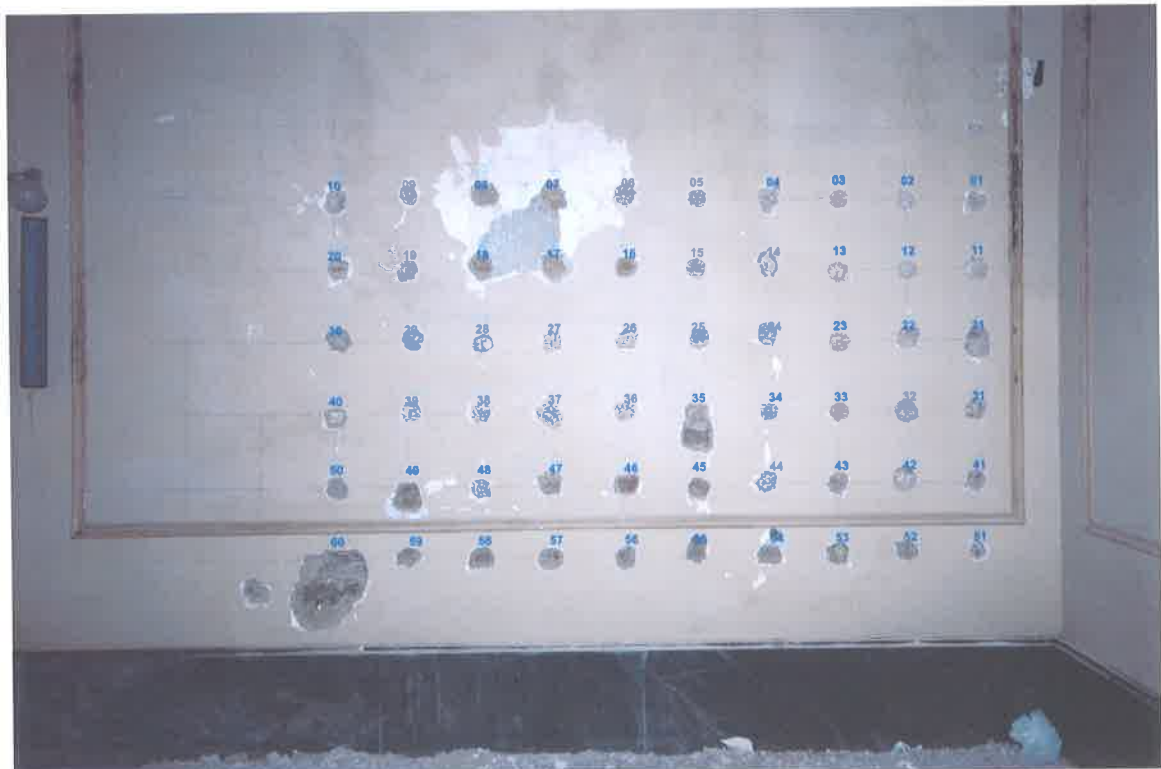
Foto n° 2. Pannello S1 parete interno Chiesa
