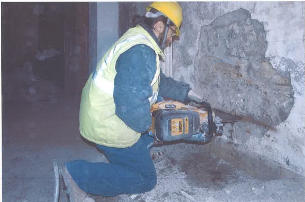
Foto 2 – Prova con martinetto piatto MD1 – Fase di taglio
