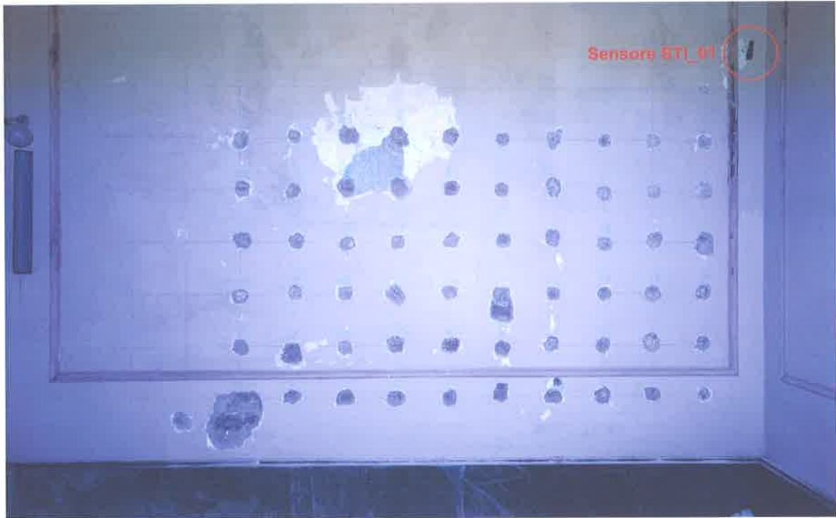
Foto 01_ Sensore STI_01 (Parete)
